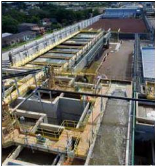
Figura 14 – Foto ilustrativa de Estação de Tratamento de Água. Fonte: Veolia, 2022.
